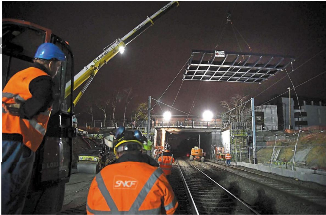
Trélazé, les Malembardières, mardi matin. L'énorme grille ressemblant à un gaufrier est le tablier qui va trouver place à côté du pont routier lors de cette délicate opération nocturne.
