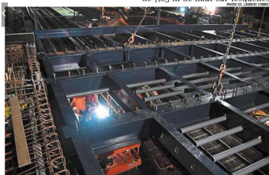
Le tablier de la passerelle est posé. Ses rectangles recevront les dalles de béton. Le ferrailage à gauche marque une partie de l'emprise de la future voie douce qui séparera le pont routier de la partie couverte de la halte ferroviaire.
